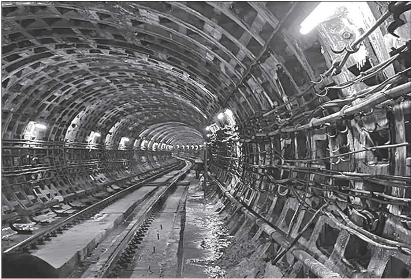
Вода тече у тунель станції метро «Либідська». 2024 рік. Питання від киян: хто винен? У відкритому доступі
